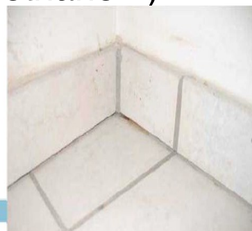
Joint périphérique défectueux
